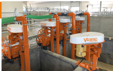
1. Pompage du fumier
